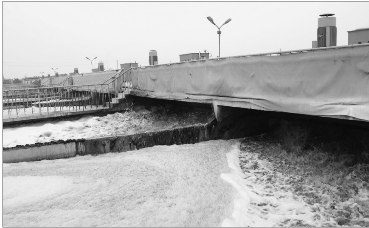
2003年5月1日起,山东省制定实施了全国最严格的造纸行业污染物排放标准,要求COD2010年1月1日降低到120mg/L,力争到2020年基本解决山东全省的水环境问题。图为山东高唐泉林纸业集团投入巨资兴建的大型污水处理设施在进行污水处理。
