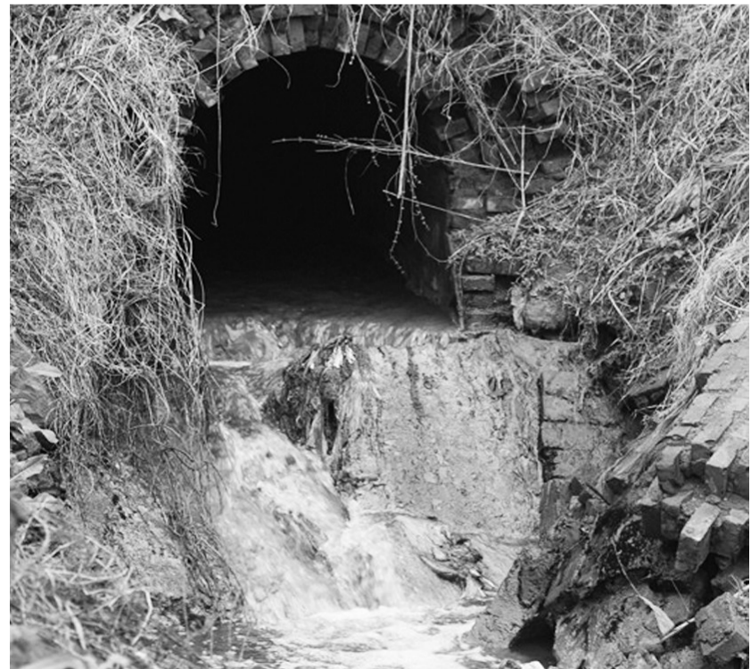
武汉段标注的1号排污口:宽度约1.2米(地点:朱家河大桥,武汉肉联厂附近)
