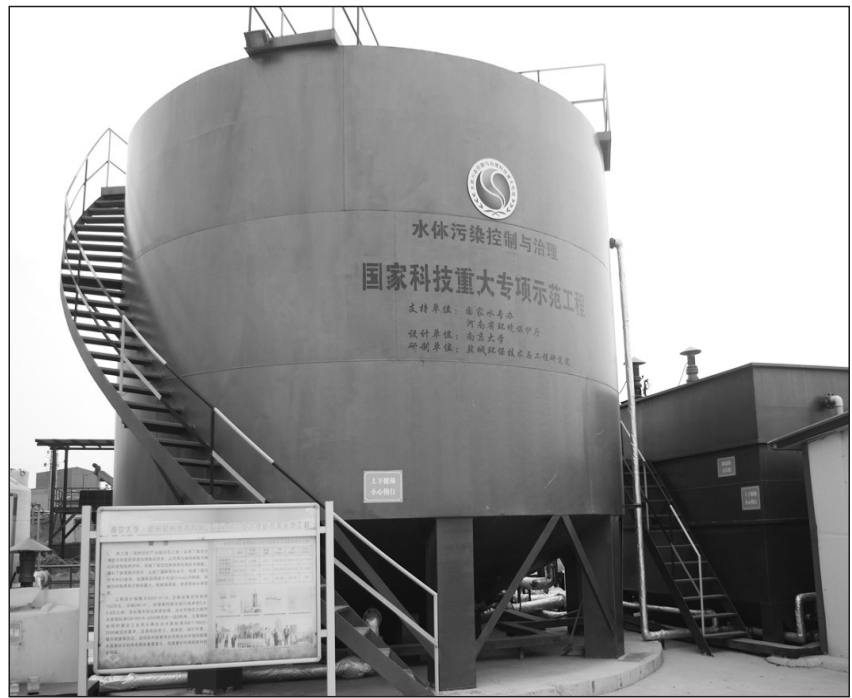
郑州纺织产业园尾水深度处理示范工程
