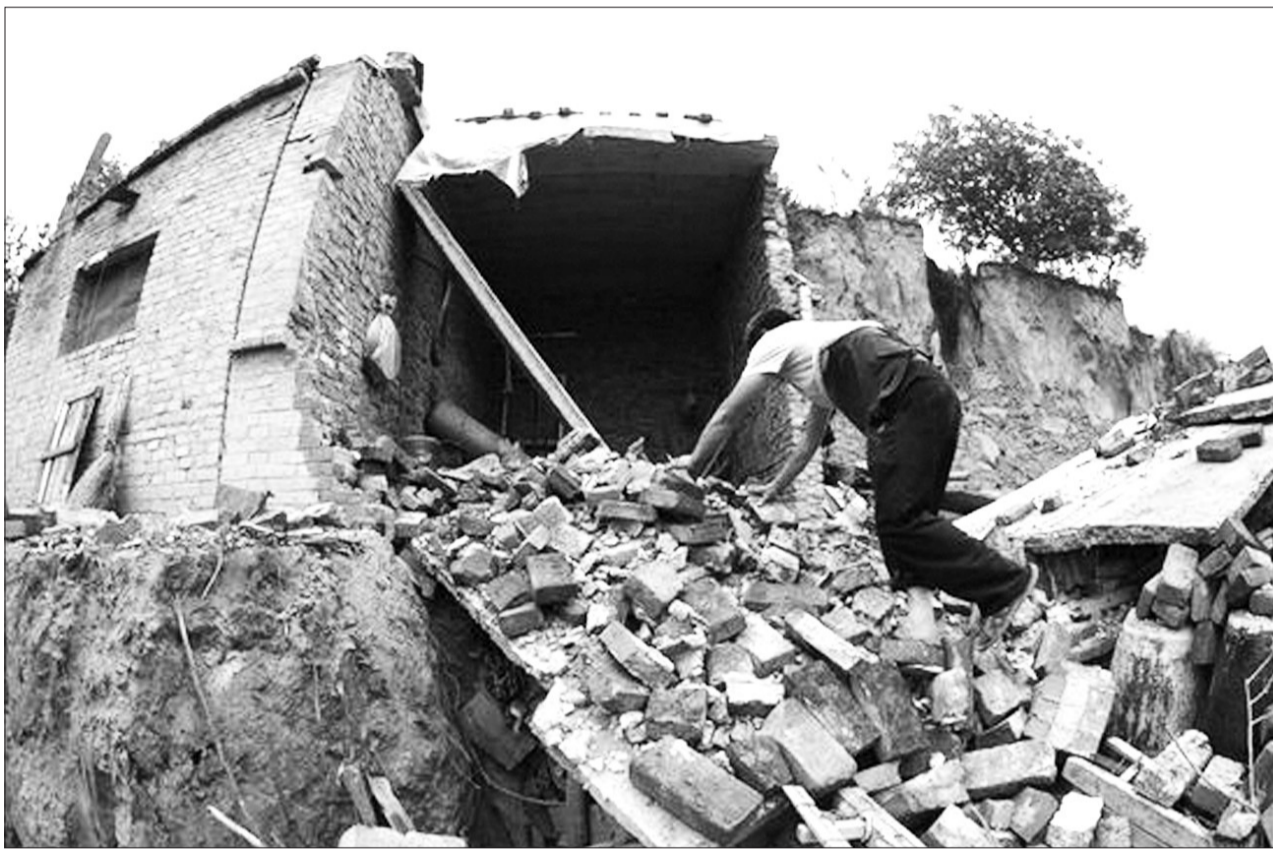
山西省吕梁市临县木瓜坪乡一村因煤矿开采而严重塌陷。
