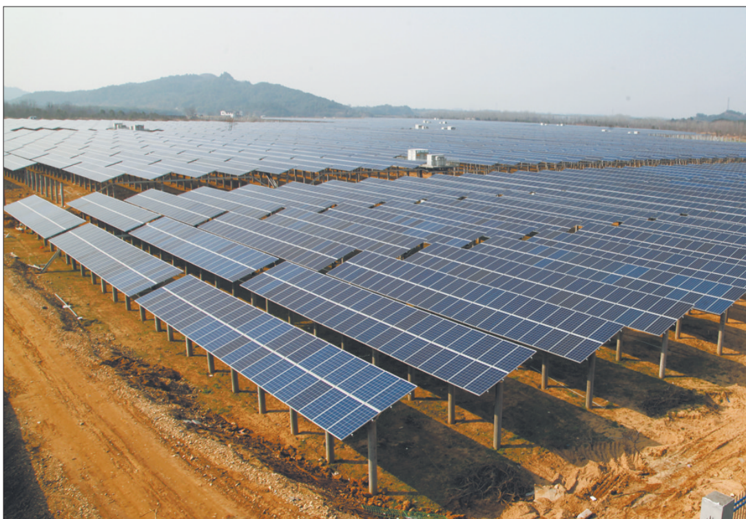
江西省最大的光伏电站——上饶市横峰杨家光伏电站日前正式并网发电。项目总装机50MW,年均发电量5500万千瓦时,按每吨标准煤可发电3000千瓦时计,项目每年可节约标准煤约1.84万吨。 人民图片网供图
