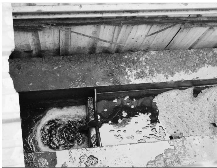
图为南通璞玉食品有限公司将清洗蔬菜的废水经过生化处理后直排雨水管道。
