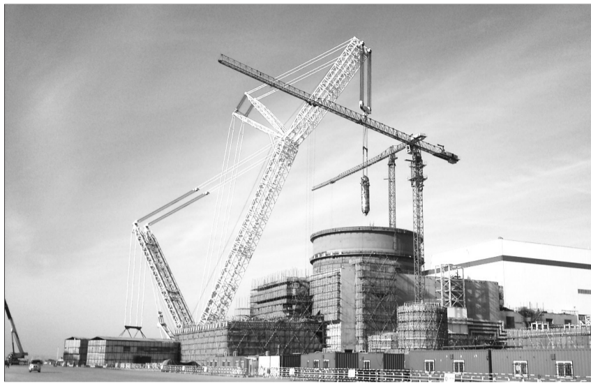
图为由中电投负责运营的山东海阳核电站。侯正磊摄
