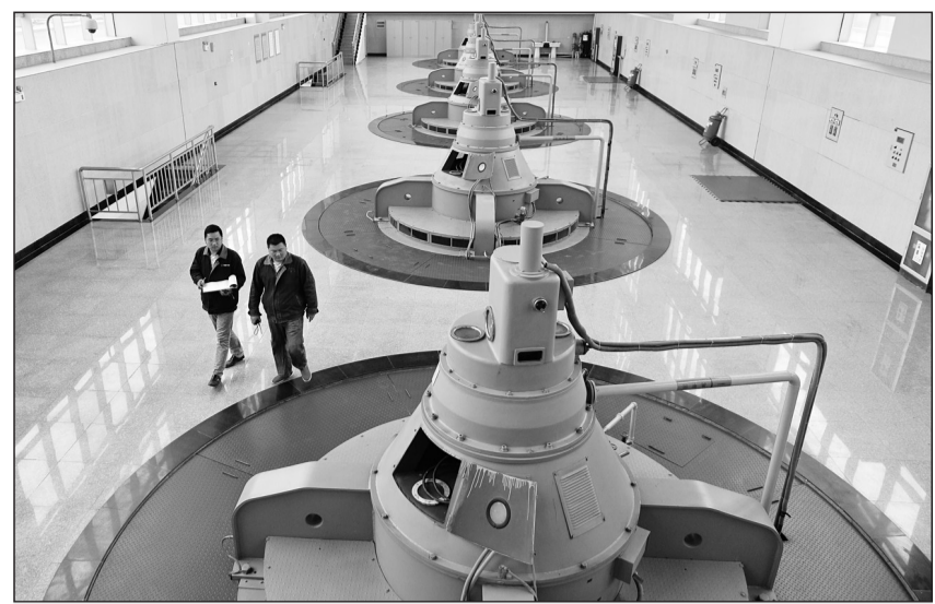
记者近日从山东省枣庄市台儿庄区南水北调局了解到,台儿庄泵站正式调水运行,计划调水3.28亿立方米,到5月31日结束。此次调水将缓解工业、农业和生态用水紧张的局面。图为工作人员在查看泵站机组运行情况。
