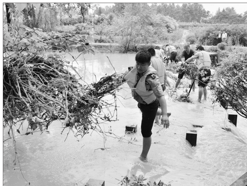
清河干渠是安徽省合肥市董铺水库的重要补水渠道,近日,受暴雨、大雨影响,夏季渠中疯长的水草在河道上游、下水口都产生了淤积,引发内涝。图为应急工作人员在清淤清河干渠中漂浮的水草和杂物。 中国日报图片网供图
