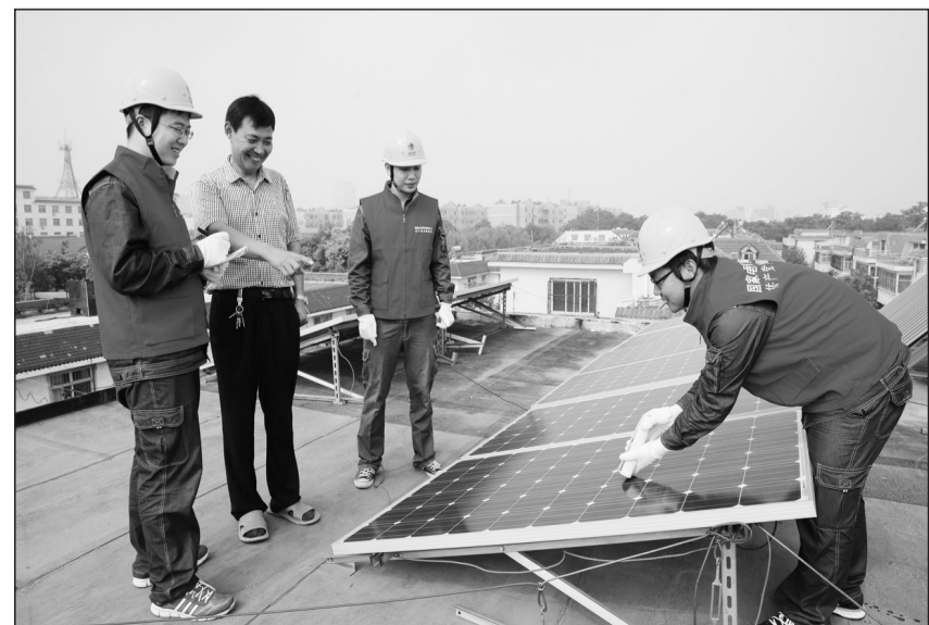
河南省鹤壁市近年来大力倡导绿色能源、节能环保项目,出台了光伏发电补贴政策,家庭光伏发电项目迅速发展。截至目前,已有20个家庭光伏发电站并网发电。图为国网河南鹤壁供电公司员工对一户居民的家庭光伏发电站进行定期安全检查。 人民图片网供图
