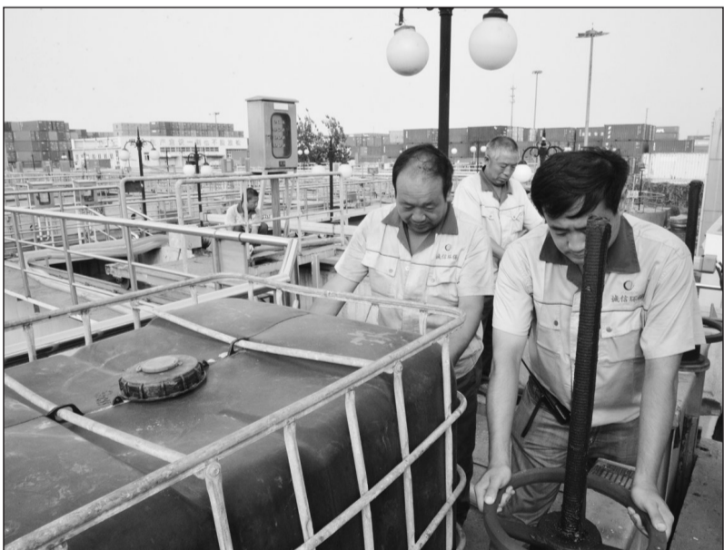
天津港保税区扩展区污水处理厂的工人们正在紧张检查调试设备。 本报记者郭文生 任效良摄
