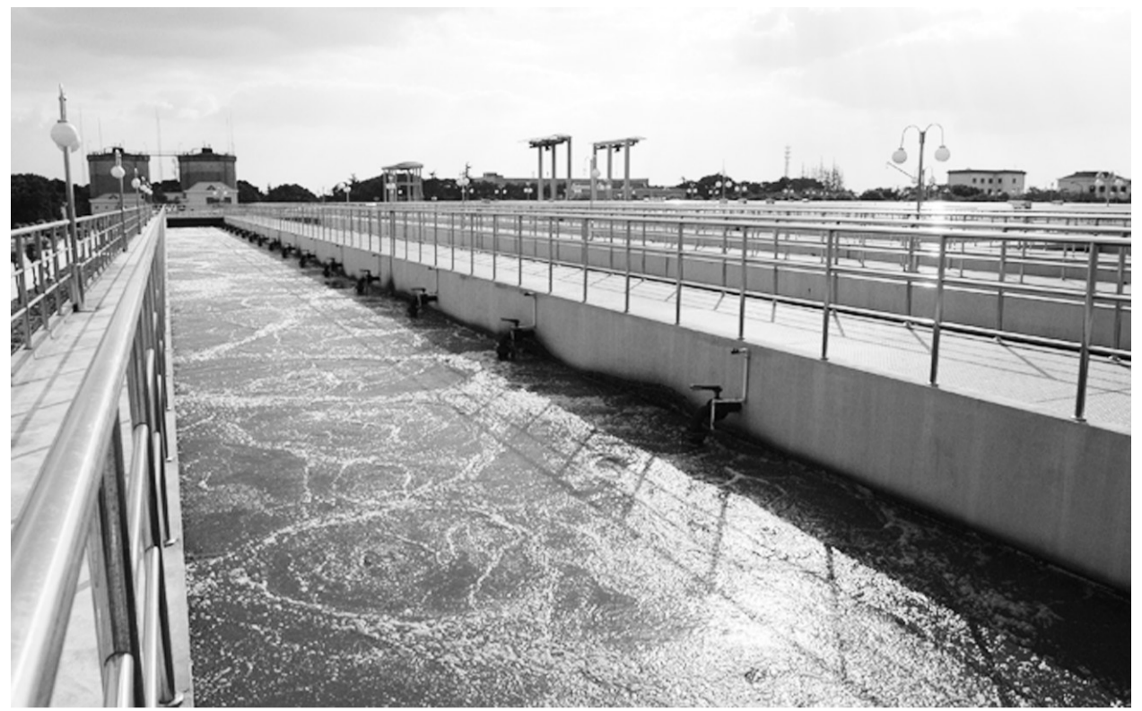
污水处理厂覆盖区域污水管网多,水量大,升级改造后仍然不能满足污水处理需求。长期超负荷运行,导致曝气设备受损严重,由于属于水下曝气,检修曝气设备必须停水。
