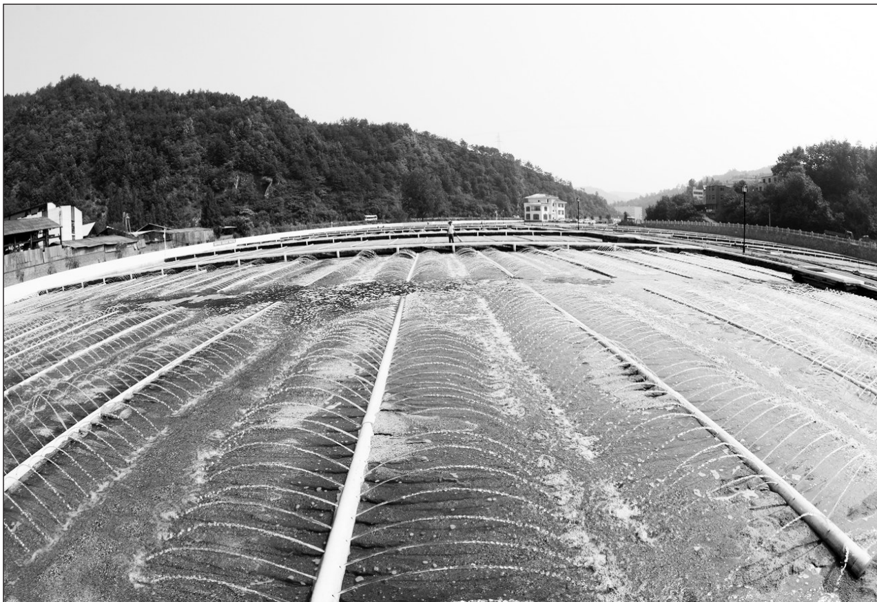
湖北省十堰市神定河下游主河道水质净化工程(一期)近日投入试运行。据了解,这项工程采用“高密度沉淀+人工快渗”工艺,日处理污水5万吨,整个污水处理系统靠自然落差运行,无需用电,出水水质主要指标达到Ⅲ类水体水质标准。 人民图片网供图
