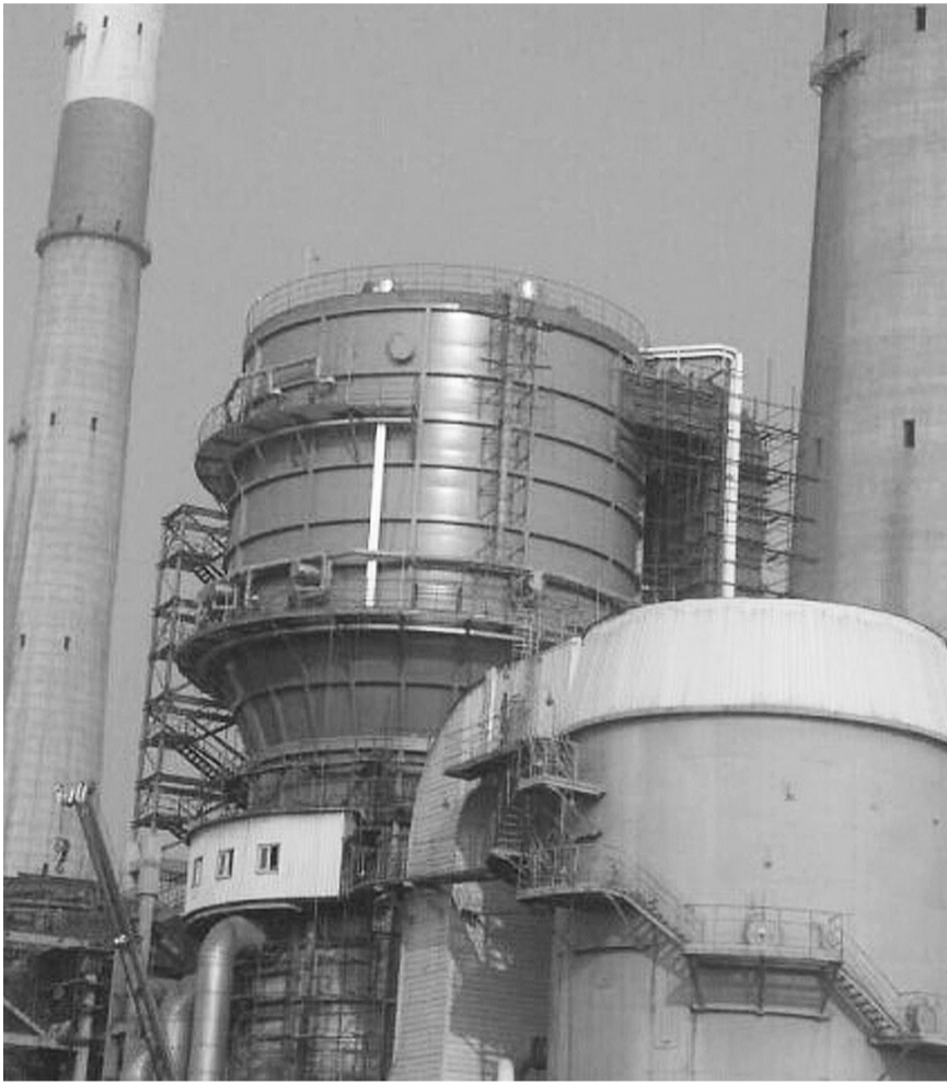
图为陕西渭河电厂3号机组除尘改造装置。
