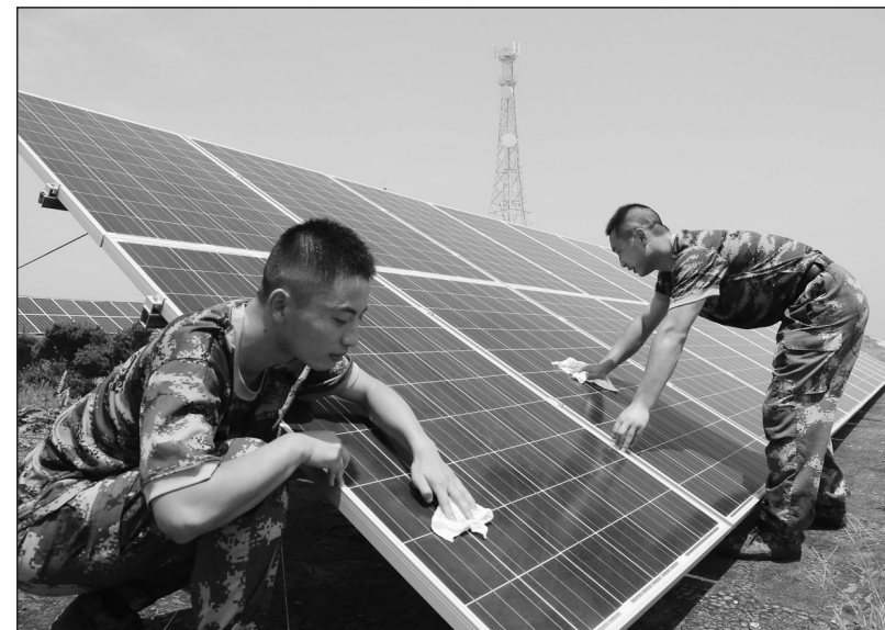
江苏省边防总队和连云港边防支队共同投资200余万元,在距离陆地60多千米的前三岛(牛牛山岛、达山岛、平山岛)建设太阳能光伏发电系统。据介绍,一天的阳光照射可以确保岛上所有电器运行60个小时。 黄金衔摄
