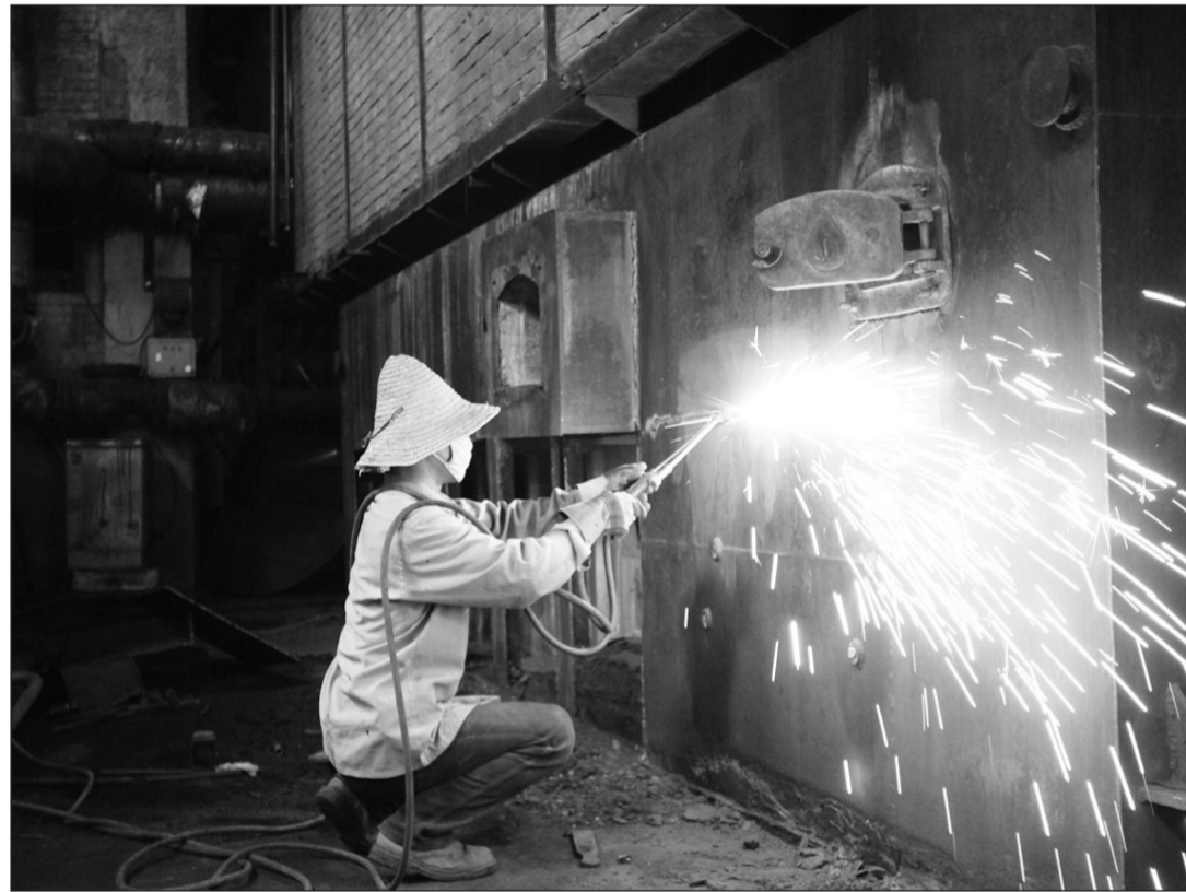
河北省张家口市宣化区严控大气污染,今年再拆除305台10蒸吨以下燃煤小锅炉,实现小燃煤锅炉有序淘汰。图为工人正在对和平街小区一台10蒸吨燃煤锅炉设备进行切割拆除。 人民图片网供图
