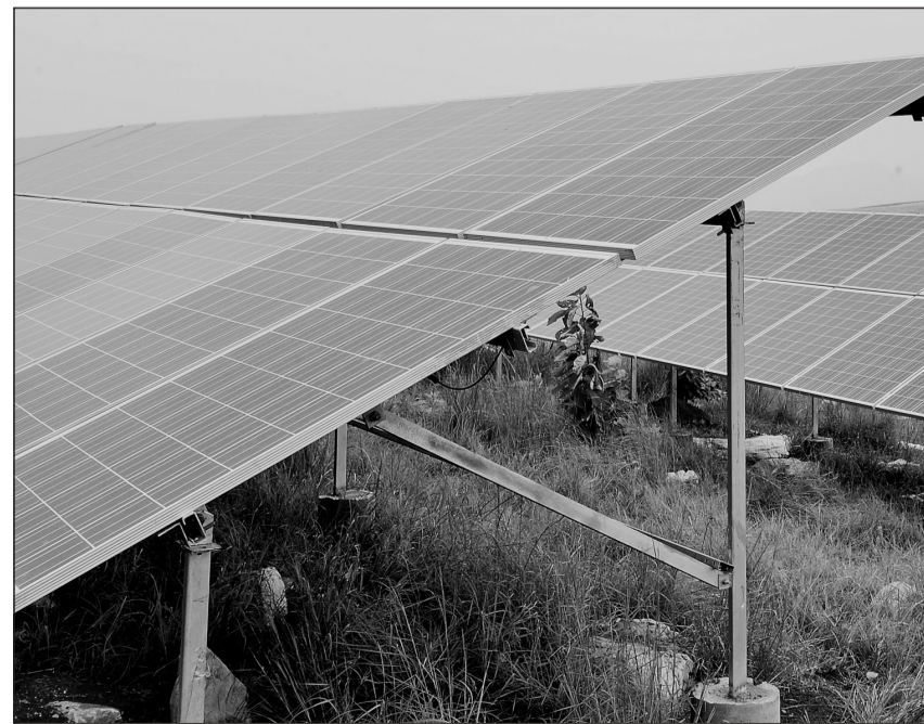
云南省建水县南庄并网光伏电站工程总投资27.8亿元,装机容量为300MW,年上网电量为4亿度。目前,电站累计并网发电894万千瓦时,累计上网电量880万千瓦时,对减少二氧化碳排放具有重大意义。 人民图片网供图
