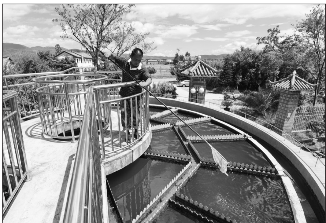
为有效解决洱海沿岸村落水污染问题,云南省大理市启动实施了洱海流域百村村落污水收集处理系统工程。这一项目涉及大理市环洱海10个镇105个重点村落,建设污水处理系统111套及配套设施管网,目前一期在36个村建设的39座村落污水处理系统、管网主体工程已完成。图为洱源县右所镇西片区污水处理厂。 本报记者邓佳摄
