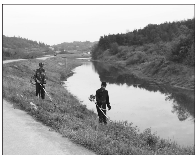
安徽省庐江县近日对境内河道、沟渠进行清障除杂,恢复渠道排水能力,疏通水系、修复生态、改善水质。目前,庐江县已开工120处,清淤沟渠200公里,清理垃圾89吨。
