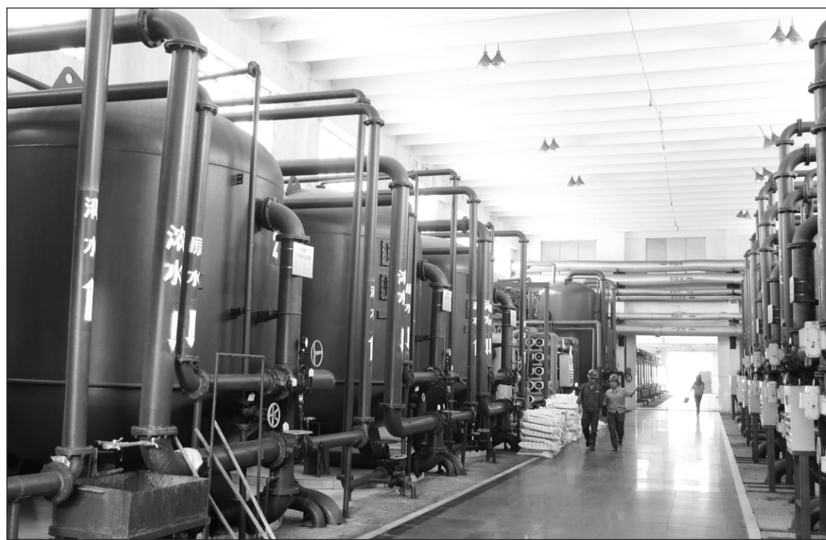
为实现水资源循环利用、减少污水排放,山东省济宁市金威煤电有限公司先后投入4000余万元,上马了污水深度处理、湿地净化、中水回用等工程,实现了企业园区生产、生活废水的多级处理、闭路循环。图为金威煤电有限公司污水深度处理设施。本报记者董若义摄
