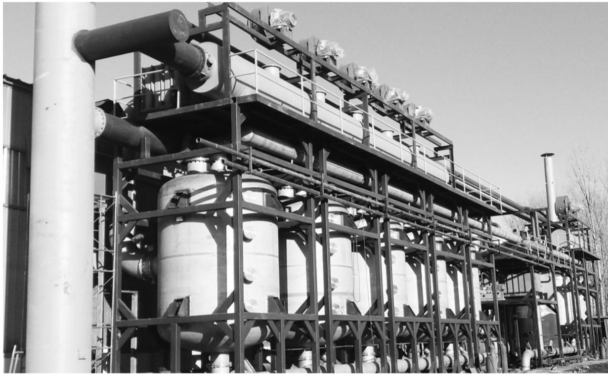
图为河北先河正源环境治理有限公司在某包装印刷企业建设的溶剂吸附、冷凝回收装置。 本报记者张杰摄
