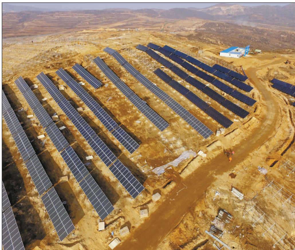
我国一些贫困县尤其是贫困山区闲置山场面积大、光照条件较好,发展光伏发电产业拥有较好基础。河北省选择了平山、曲阳等6个县作为首批光伏扶贫试点县,开展长达20年的持续帮扶,有效改善了当地经济状况。图为建设中的河北省临城县下峪42兆瓦光伏发电项目。
