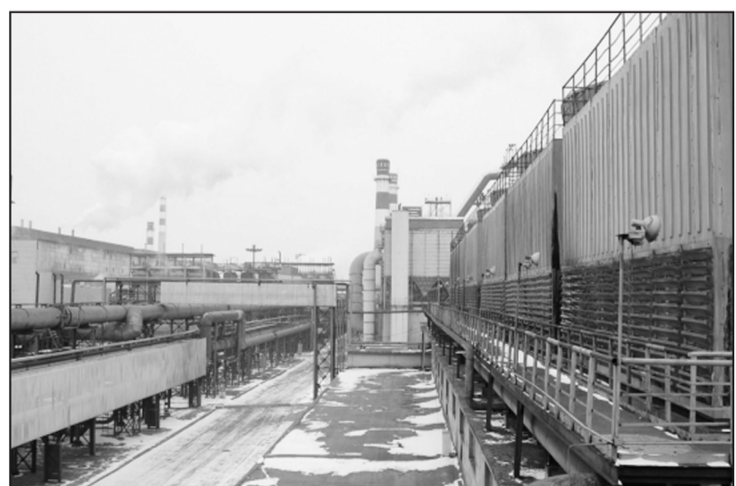
抚顺特钢公司烟气治理一隅(右侧为除尘装置)。
