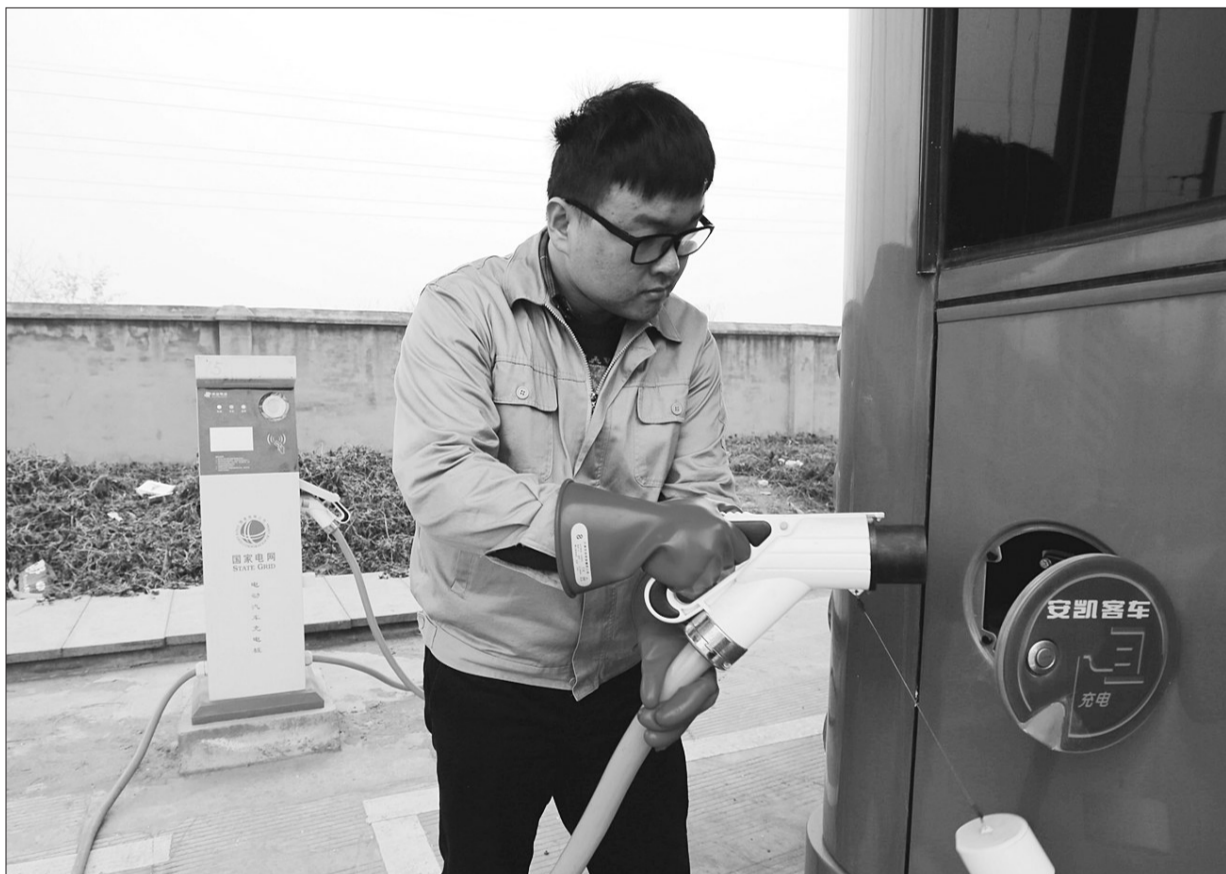
随着安徽省合肥市新能源电动公交车数量与路线进一步扩充,瑶海充电站二期工程于12月初正式投入使用。据悉,经扩建后的瑶海电动汽车充电站共拥有71个充电桩,可服务142辆公交车。 人民图片网供图
