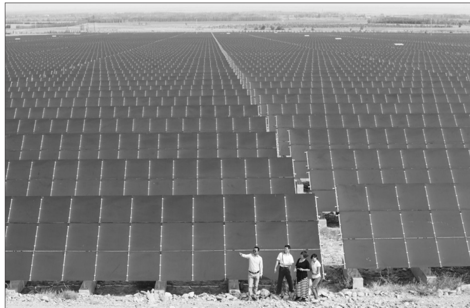
新疆维吾尔自治区吉木萨尔县庆阳湖乡双河村南部戈壁的汉能光伏电站一期20Mwp项目,近日将并网供电。一期项目与同等发电量的火电相比,相当于每年可节约标准煤9000多吨,减少二氧化碳排放量两万多吨。据了解,这个项目是昌吉州最大的利用太阳能发电项目,分为四期,总装机容量为100Mwp。
