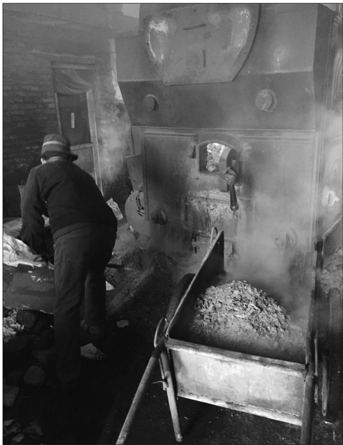
石丰桥下一无名小洗灰店内,工作人员正在清理小锅炉灰渣。 董克难摄
