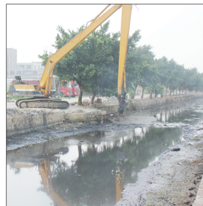
整治前的华美沟渠。
