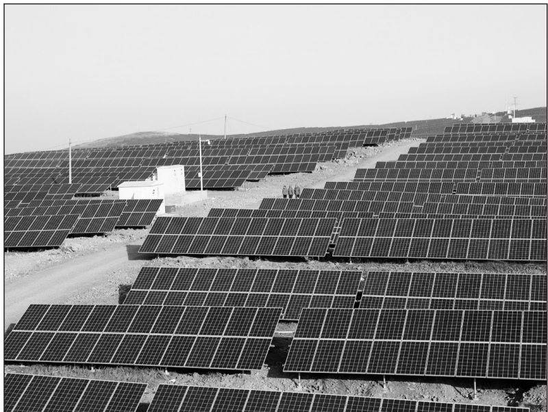
河南省首个地面大型光伏电站近日在汝阳县建成投入使用。据了解,这一项目总投资2.5亿元,预计年发电量可以达到3356万千瓦时,实现了河南省地面大型光伏电站建设投入使用零的突破。
