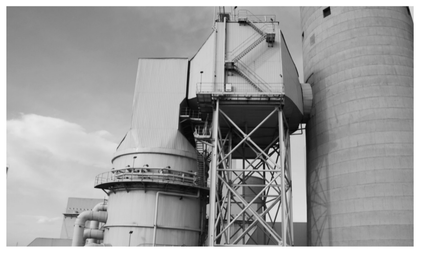
脱硫除尘塔装置。
