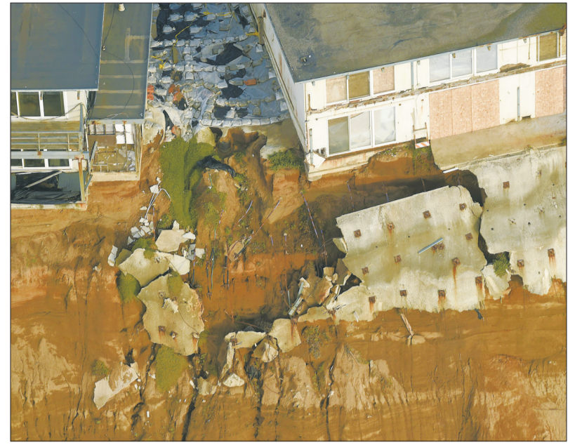
厄尔尼诺现象加快了对美国加州太平洋海岸的侵蚀,导致这一地区部分地面坍塌,几栋海滨公寓岌岌可危。图为1月26日美国加州帕西菲卡市沿太平洋海岸部分地面坍塌。新华社供图
