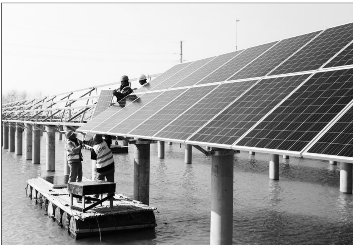
在山东省乐陵市铁管镇循环经济示范园的中广核乐陵太阳能光伏并网发电工程项目现场,工人们正在铺设多晶硅太阳能板。据了解,项目全部建成后,每年可发电2500多万千瓦时。 人民图片网供图
