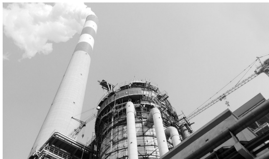
继1号燃煤机组改造完工后,河北建投沙河电厂近日完成了2号机组的超低排放改造工程。图为改造完成后的2号机组脱硫吸收塔。
