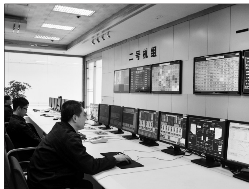
2015年以来,潍坊市为改善环境空气质量,要求全市燃煤机组进行超低排放改造,减少大气污染物排放。图为华电潍坊发电公司工作人员监控超低排放机组运行情况。孙鹏摄
