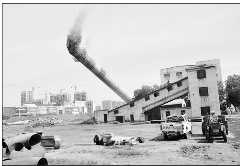
新疆维吾尔自治区昌吉市日前对位于市中心的庆源热力公司80米高大烟囱成功实施定位爆破,对两台40吨和1台80吨燃煤锅炉实施拆除。按照昌吉市今年“清新空气”行动计划,昌吉市还将于今年10月前,拆除中热热力燃煤锅炉,对西部热力和兴隆热力两家供热企业实行天然气改造。本报记者杨涛利 通讯员高一豪摄
