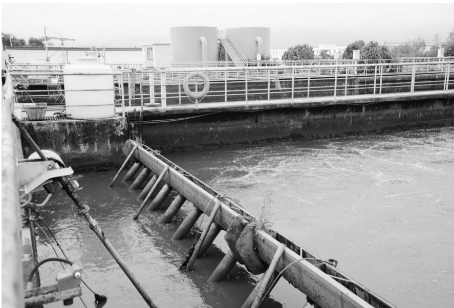
云南省玉溪市澄江县污水处理厂2000年5月建成投运,经过厂区扩建和设备技术改造,现处理规模达1.5万立方米/日,出厂水质持续稳定达到一级A标准。图为正常运转的污水处理厂反应池。 蒋朝晖摄
