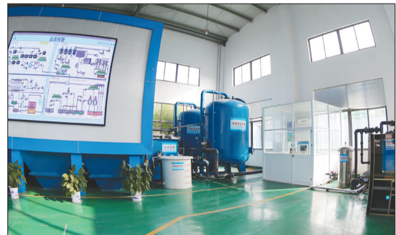
建在生产区内的环保处理设备控制室。
