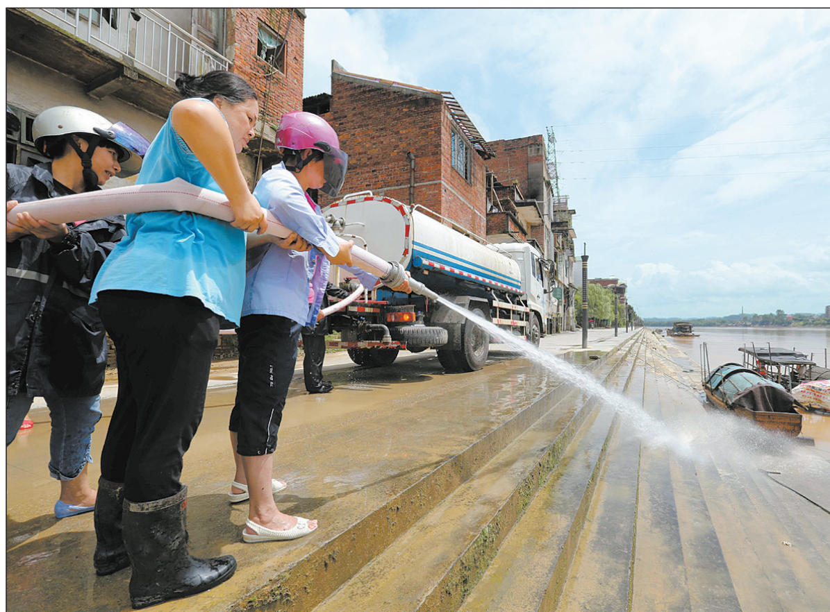
连日来,珠江上游的广西柳州市融安县融江水位不断上涨,7月3日出现115.86的洪峰水位,超警戒水位1.26米。图为洪峰过后,当地党委政府组织党员干部和沿岸群众开展清淤工作,查看受灾情况,帮助受灾群众恢复生产生活。
