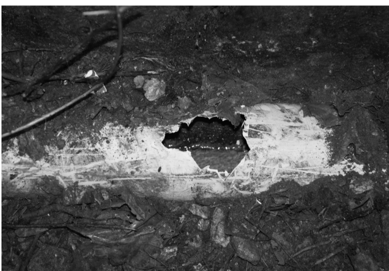
图为排污管道被挖开后,未经处理的电镀废水顺势流出。王槐摄
