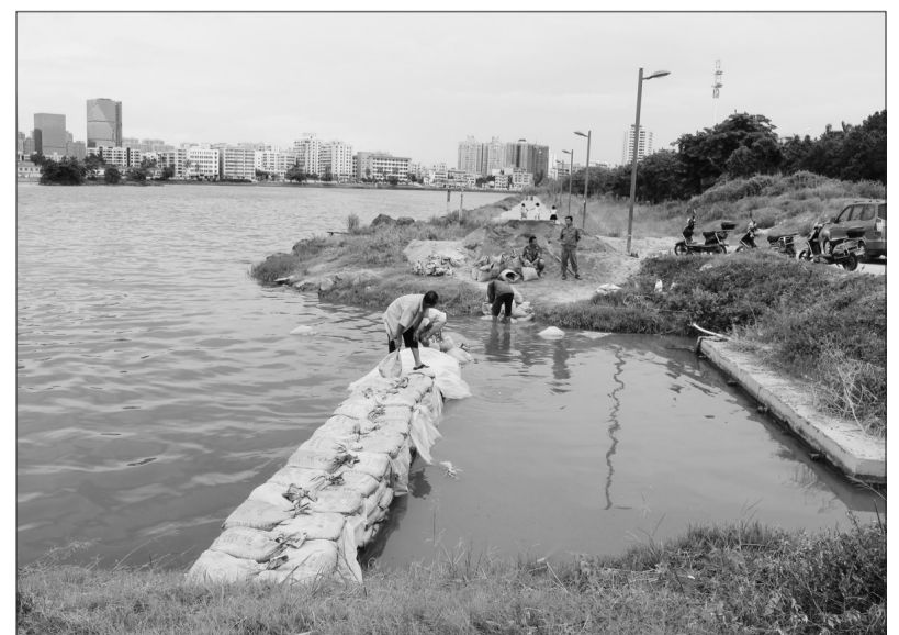
海南省海口市正在加强城镇内河黑臭水体治理。图为工人正在琼山区红城湖西南角的生活污水排放口附近铺设沙袋,对污水进行截流、清淤,再通过泵站将污水提升到市政污水管网进入环保处理。 孙秀英摄
