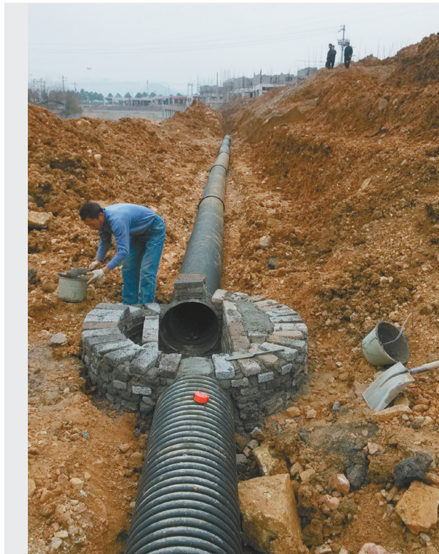
铜仁市万山区污水管网建设,将为该地区的污水收集,为全市污水治理发挥重大作用。
