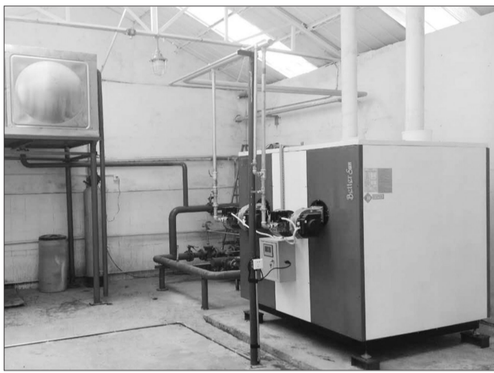
图为倍他暖冷凝模块锅炉正常运行。
