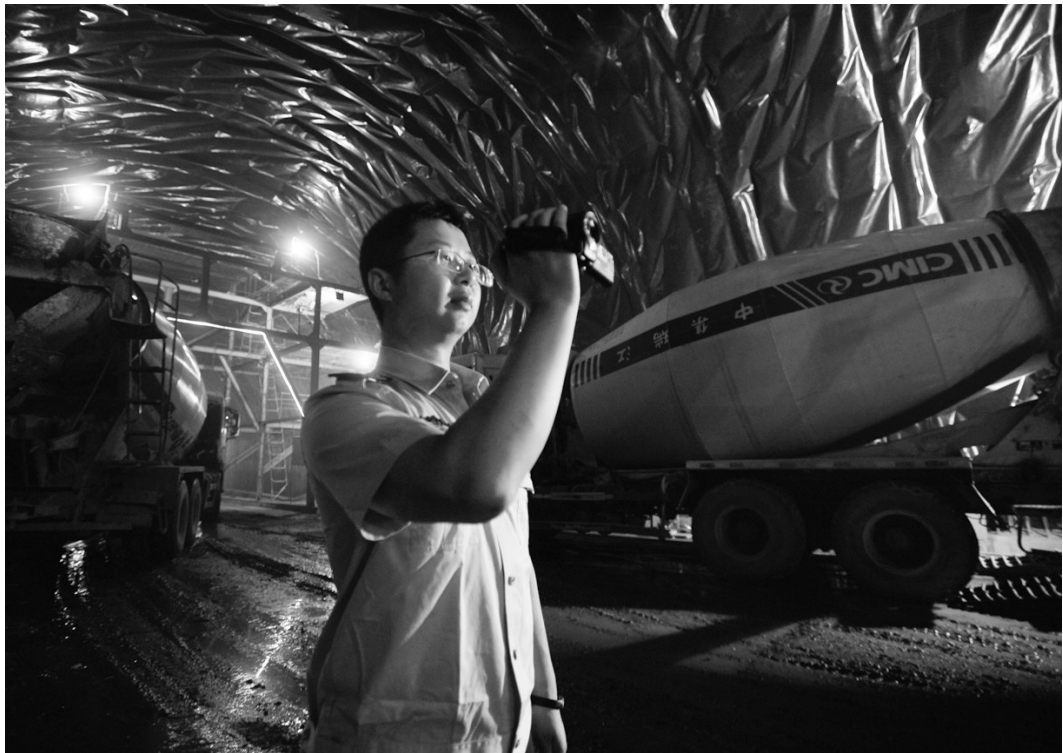
图为重庆市环境监察总队执法人员在某处夜间违法施工隧道工程现场调查取证。重庆市环保局供图
