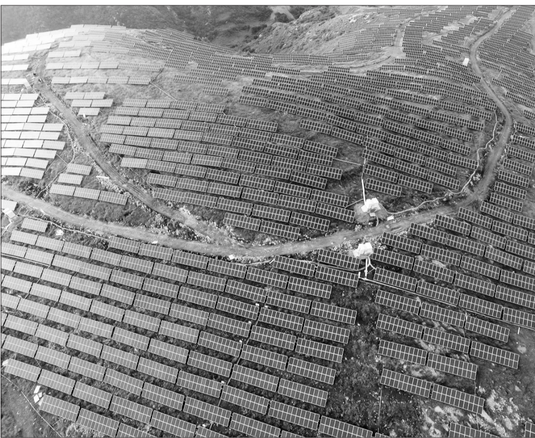
河南省宜阳县董王庄乡50兆瓦分布式光伏电站建设现场,昔日荒山石场,今天成光伏海洋。据了解,这一项目总投资4.5亿元,建成后年发电量可达6000万千瓦时。人民图片网供图
