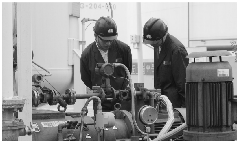
图为VOCs治理技术需方企业在中国石化山东石油分公司济南油库参观油气回收装置。
