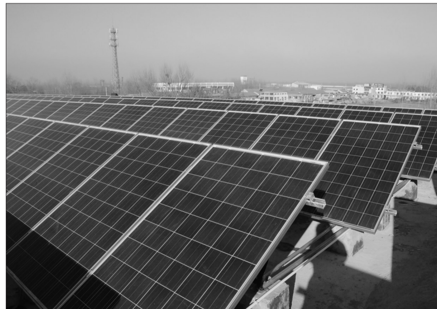
山东省商河县与山东力诺瑞特新能源有限公司合作,打造零碳示范区,日前建成玉皇庙镇政府办公楼56kw分布式光伏发电项目和太阳能路灯项目。56kw分布式光伏发电项目,每日发电量约为197度,全年发电量达到7.19万度,预计25年总收益达到188.7万元。李妮妮 王文硕摄
