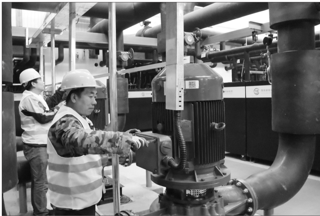
为落实《大气污染防治行动计划》和北京市清洁空气行动计划,在北京市农委、环保局、发展改革委、财政局和各区政府的密切协作下,城区民用煤清洁能源替代累计改造47个街道和94个村,共计7.5万户居民,年用煤量减少22.5万吨。图为海淀区明光村社区建设的燃煤替代集中电锅炉房。本报记者邓佳摄
