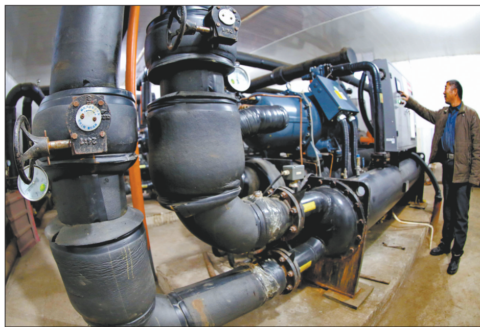
近年来,秦皇岛市海港区东港镇柳口村采取水源地热泵机组为居民供暖。该系统利用水与地能(地下水、土壤或地表水)进行冷热交换作为水源地热泵的热源,具有可再生利用、占地面积小、节约水资源、有利环保等特点。图为工作人员检测调试水源地热泵机组。 曹建雄/摄 人民图片网供图
