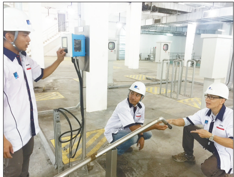
图为北控水务工作人员在马来西亚吉隆坡Pantai II 污水处理厂现场。北水摄
