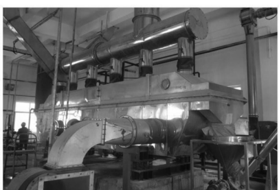
图为工业园区硫酸铵焙制项目设备。
