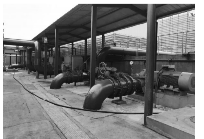
图为工业园区循环水系统。
