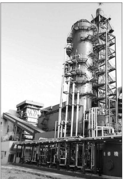
图为河北建滔工业园锅炉烟气超低排放工程。
