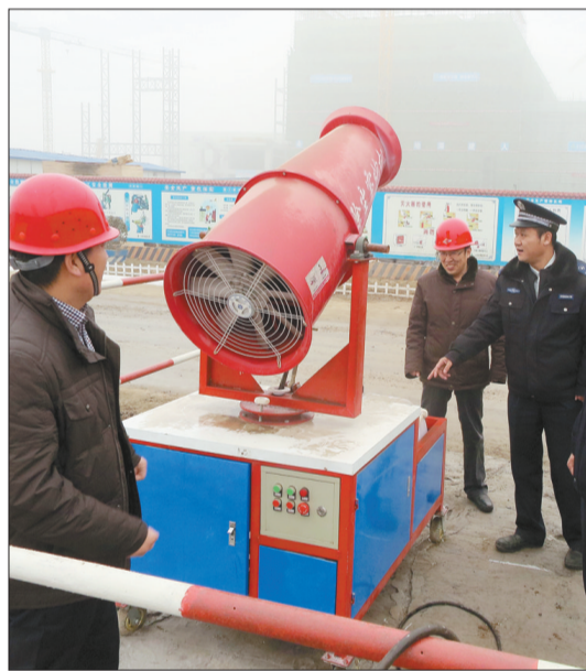
按照环境环保部统一预警要求,北京市启动了空气重污染橙色预警。图为北京市环保监察总队的工作人员在北京某垃圾焚烧发电厂建设工地检查预警期间施工工地停工情况。
